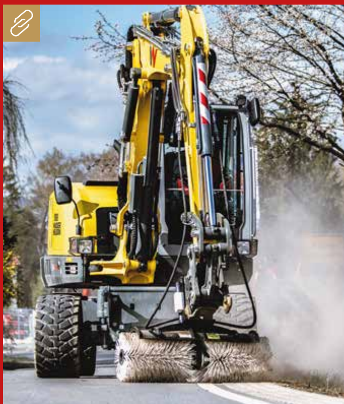
Die DMS-Bodenfräsen können in kurzer Zeit mit Hilfe von wechselbaren Aufsätzen in einen Kehrbesen verwandelt werden, was die Auslastung des Baggers zusätzlich erhöht. Bild: DMS
