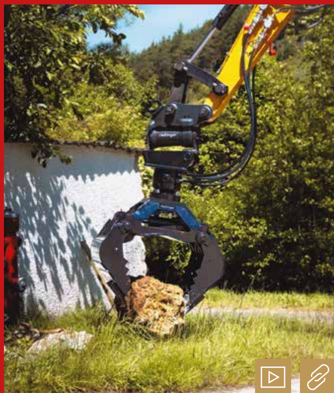
Der Universalgreifer von Rädlinger ist präzise steuerbar und für unterschiedliche Anwendungsbereiche geeignet: Randsteine setzen, Natursteinmauern errichten oder Material sortieren. Bild: Rädlinger
